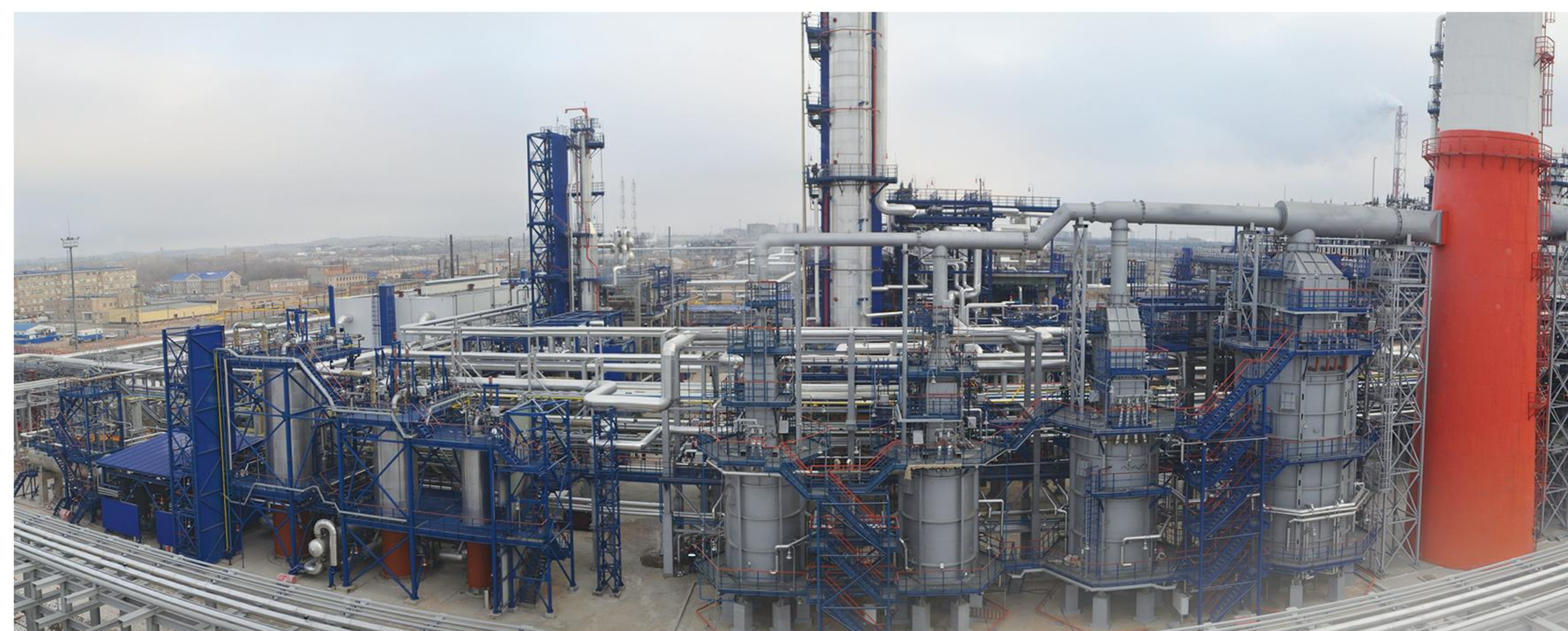
Блок печей на установке изомеризации с предварительной гидроочисткой сырья ОАО «Орскнефтеоргсинтез»
